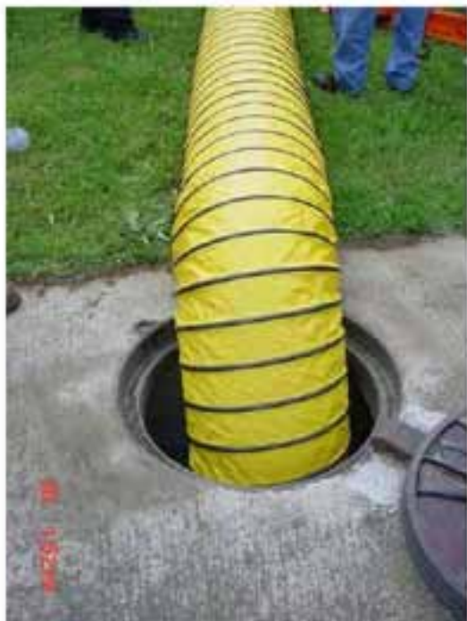
Tubo di mandata dell'aria all'interno di uno spazio confinato. Il tubo è di tipo estensibile ed è collegato ad una pompa.
